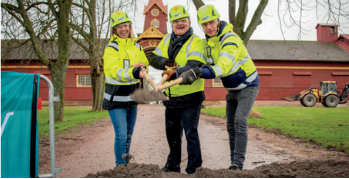
Från v. i bild: Marie Hafström, bygglédare IP-Only, Stefan Pettersson (M), ordförande i samhällsbyggnadsnämnden och Pontus Borg, platschef NCC, markerade starten för andra etappens fiberutbyggnad.
